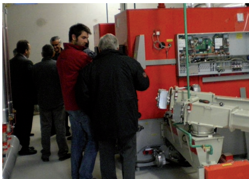
Le démarrage des chaudières
